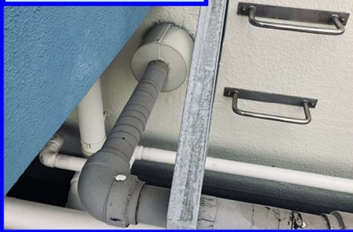
既存外壁貫通消火配管
