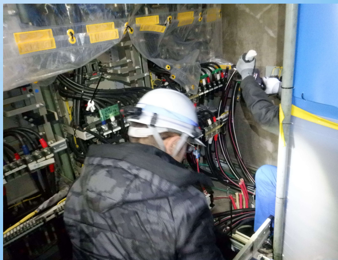
南棟電気室低圧切替状況
